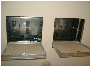
天井点検口 （分配ユニット用）
